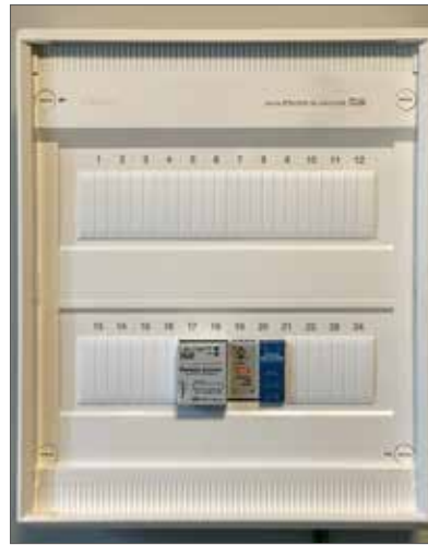
Zweifach Verteiler aufgeräumt und in geschlossenem Zustand
